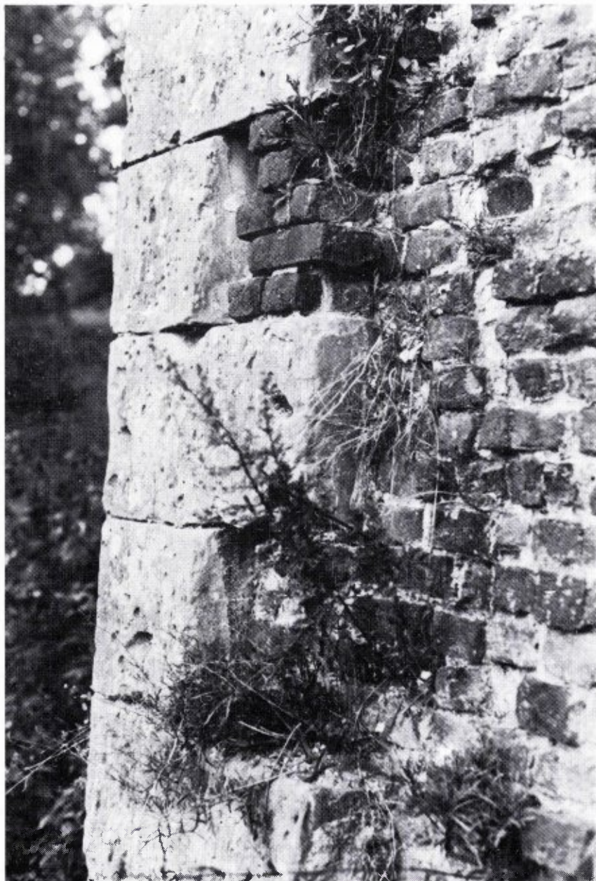
Figuur 3. Detail van de muur van fig. 2: Foto A. Zuiderwijk.
